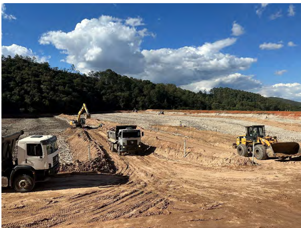
Foto 4 – Reservatório – Em andamento obras de escavação e aterro do reservatório para o projeto de descaracterização da barragem.
