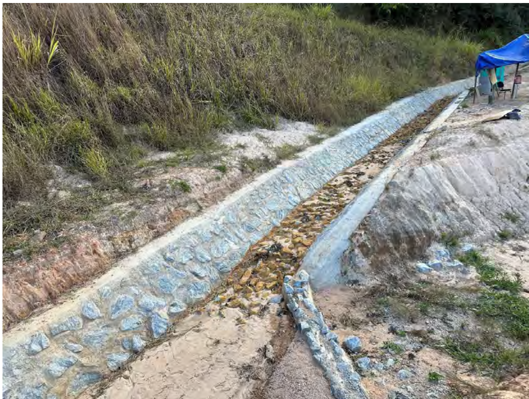
Foto 7 – Caneleta de cintura executada na margem direita do reservatório, na cabeceira, conectada com o canal extravasor – Etapa do projeto de descaracterização da barragem.
