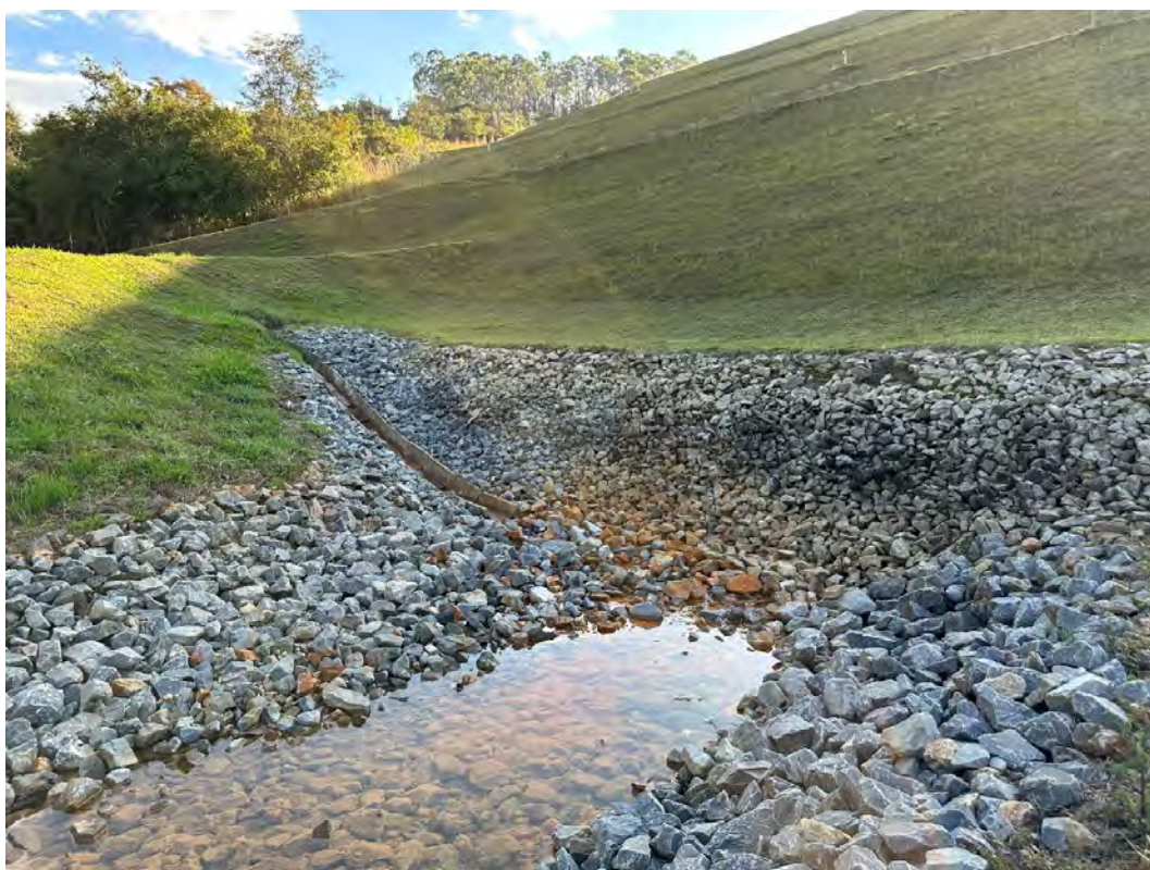
Foto 20 – Saída dreno de fundo.
