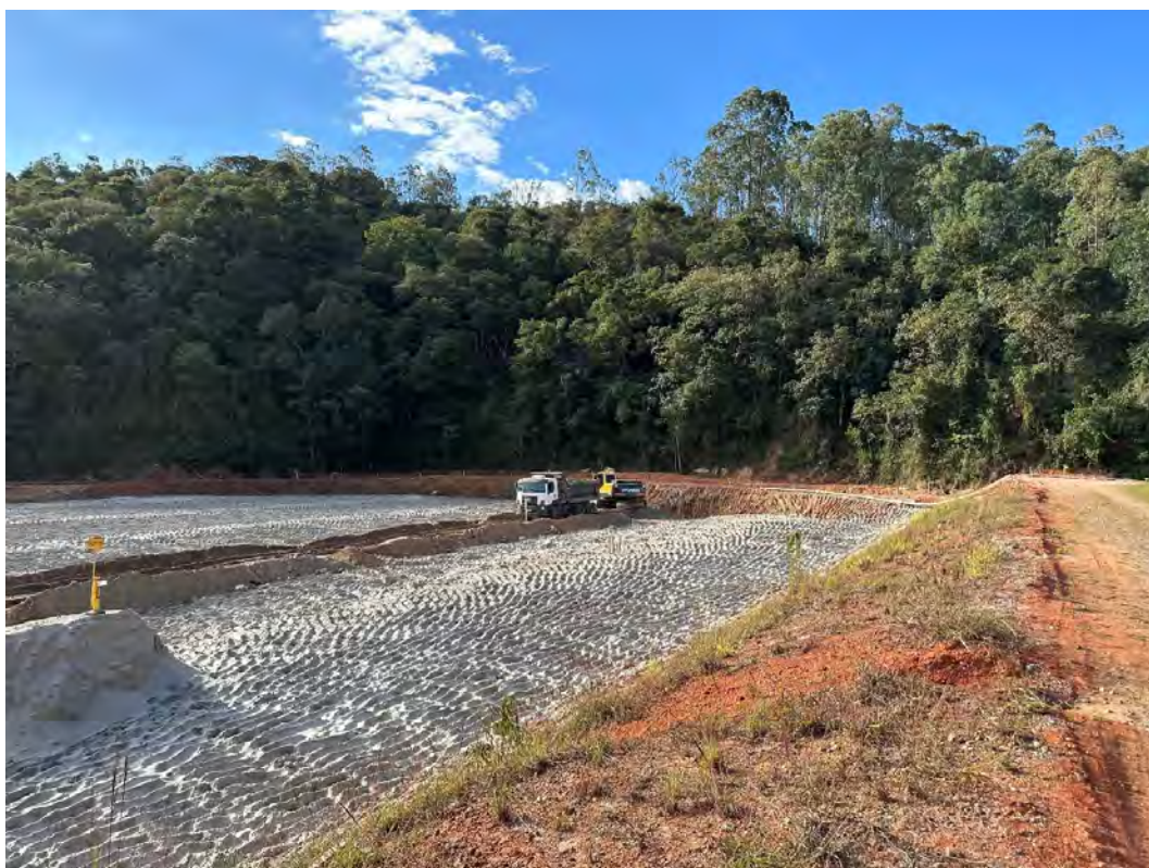
Foto 6 – Reservatório – Em andamento obras de escavação e aterro do reservatório para o projeto de descaracterização da barragem.
