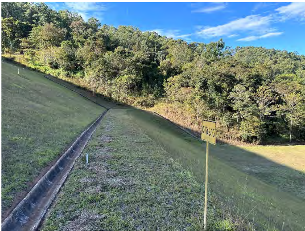
Foto 17 – Talude de jusante – Berma da cota 955 m – Vista para a ombreira esquerda.
